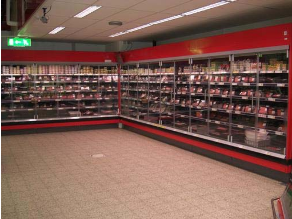
PanDur singelglasdörrar eftermonterade på väggkyldisk AQ
